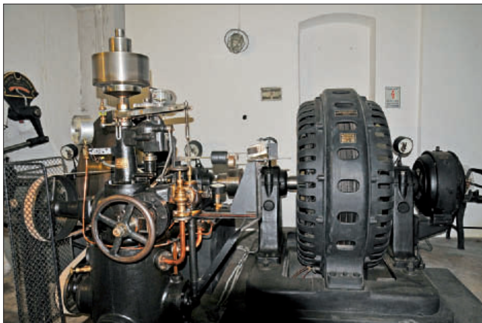
Vybavení strojovny je ještě v původním stavu a funkční. Na snímku generátor na výrobu proudu a regulátor s natáčecím ústrojím
